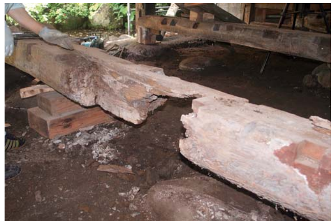
図5：蟻害を受けた大引
